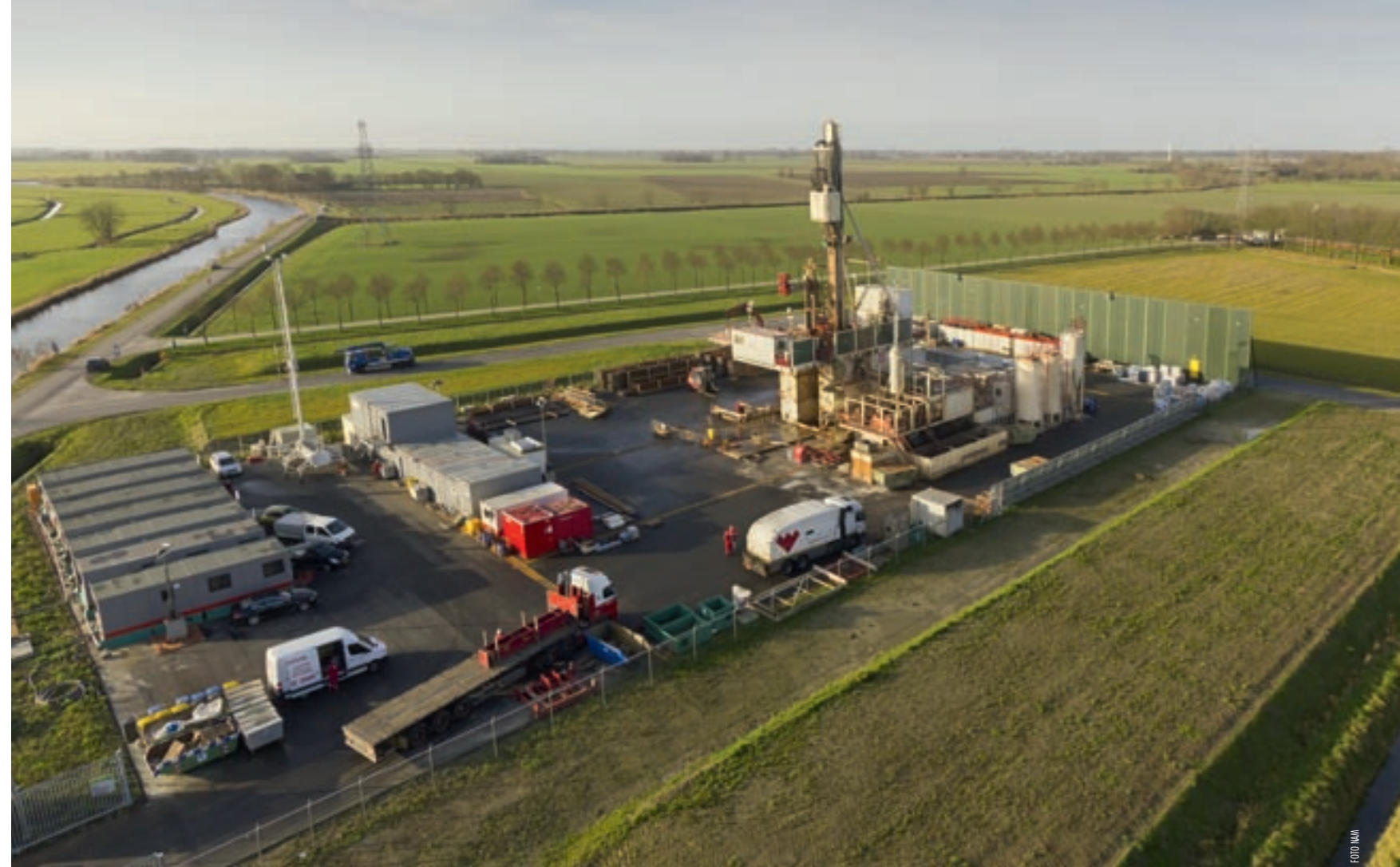
Het boren van een put voor de winning van conventioneel gas in Nederland. Om bodemverontreiniging te voorkomen krijgt de locatie een vloeistofkerende laag en een putkelder.
